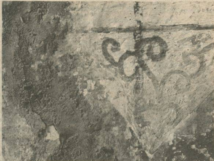
DETALLE DE UN INTENTO DE RECONSTRUCCION: EL CEMENTO CUBRE LAS PINTURAS
